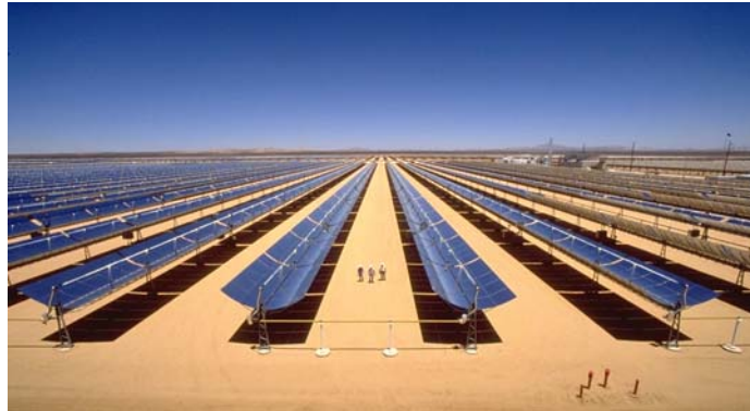
Fotografía A1.3. Campo de colectores ccps
